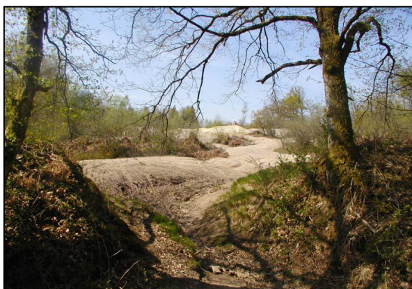
Photographie 3 : Brèche dans la digue de retenue du dépôt 87_0027_a_t1 et matériaux gris fins observés à l'aval (EDA, 2009)
